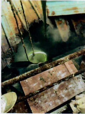
污水处理站进口
