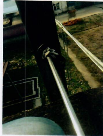
柴油锅炉排气筒
